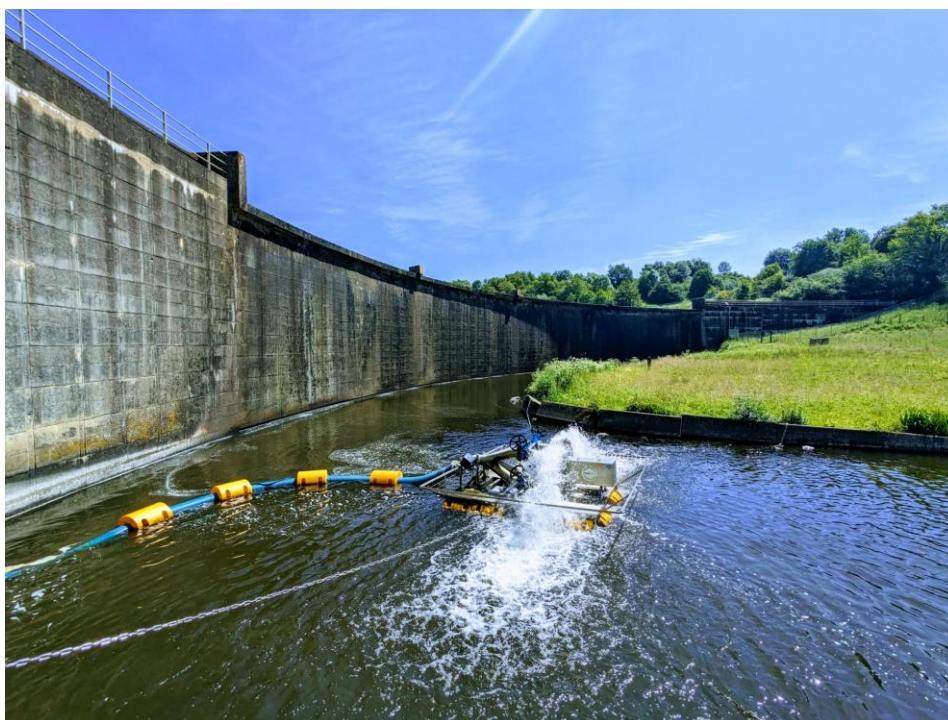
Micro-turbine au barrage de Ribou (2024)
